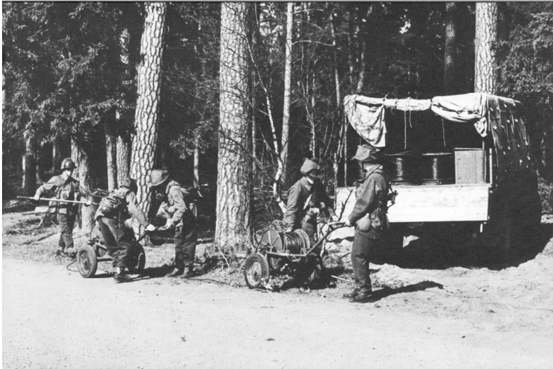
Bilden visar en tung kabelbilgrupp under arbete i Kronparken vid S 1 dåvarande förläggning i Uppsala. Uniformerna är m/52-58
