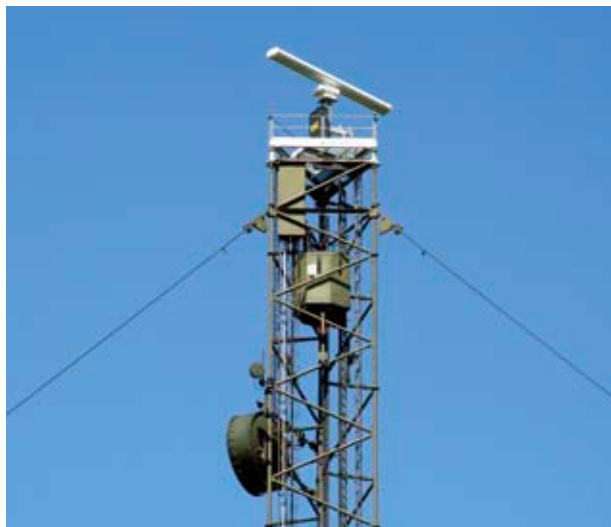
PS 640 efter montering av antenn.
